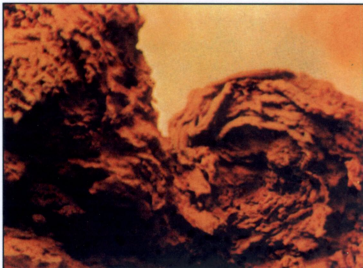
Depositi in formazione all'interno di un forno a combustione mista, in assenza di soffiatori.
